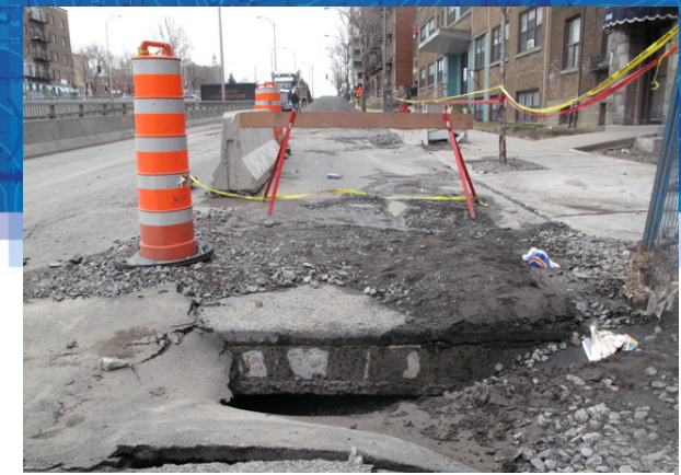
Bris d'une conduite dans Côte-des-Neiges, 17 avril 2011 (photo : QMI)
